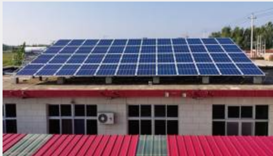
华夏金租户用光伏电站
