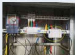
江苏省连云港市某科技有限公司 三车间和四车间物联网设施
